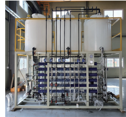
순수제조장치(DI Water System) / 발전설비
