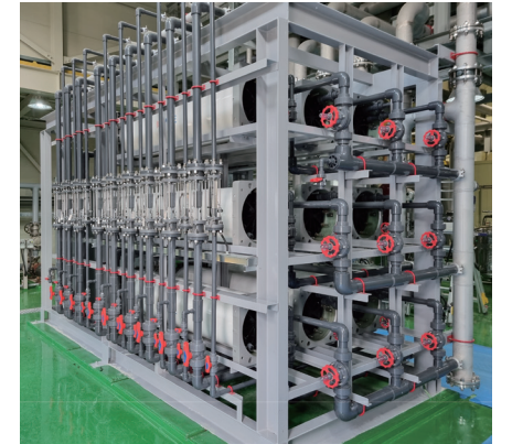
순수제조장치(DI Water System) / 반도체 공정용수
